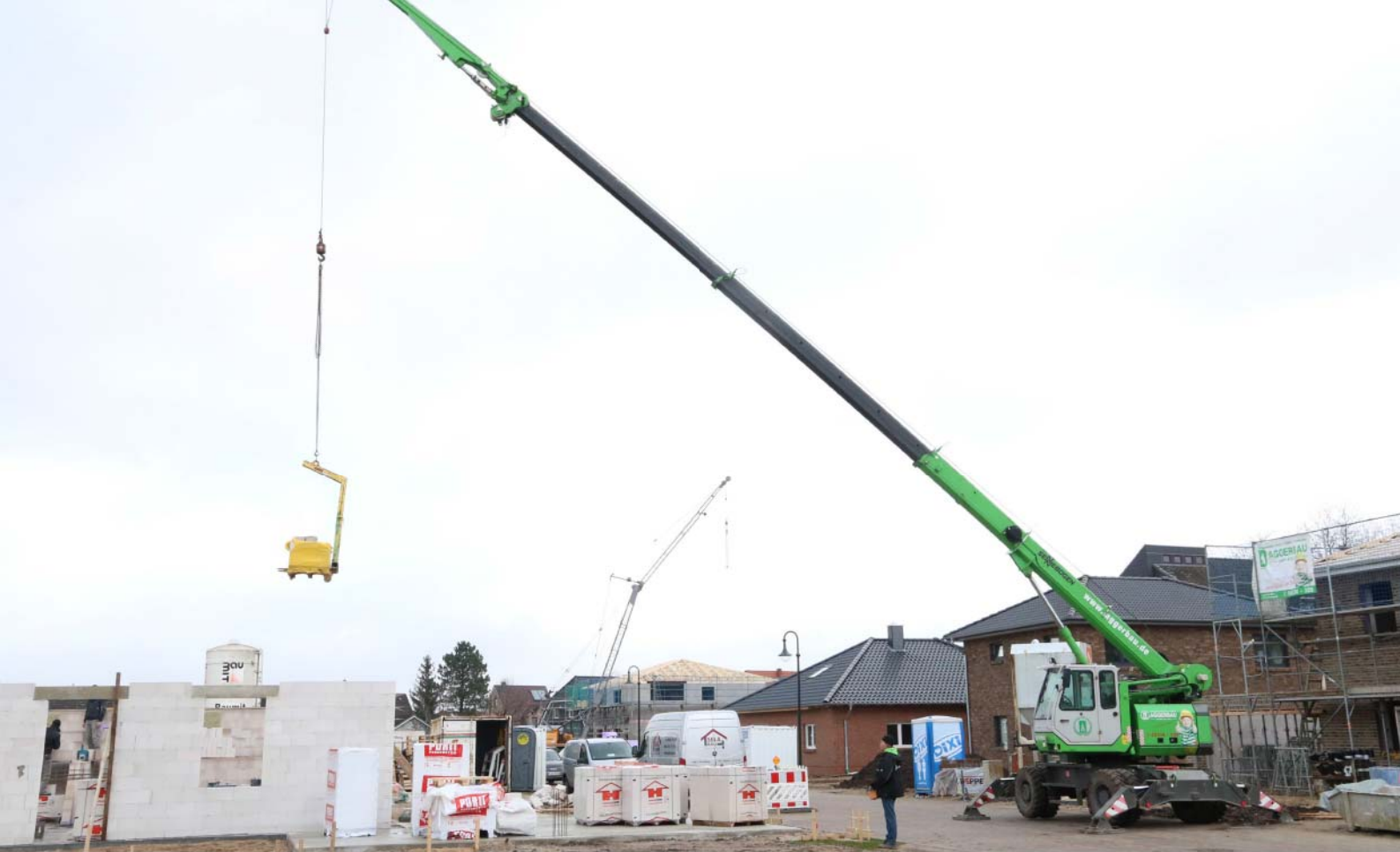
Der 613 E Mobil optimiert die Baustellenlogistik bei der Fertigstellung eines Einfamilienhauses in Deutschland.
